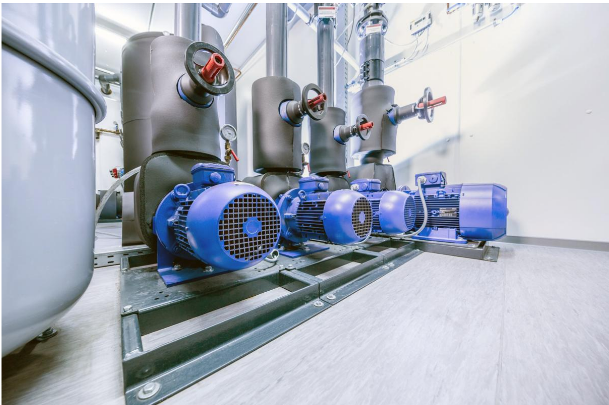
Abbildung 1: Beispielhafte Installation von Kreiselpumpen in einem industriellen Pumpenhaus
