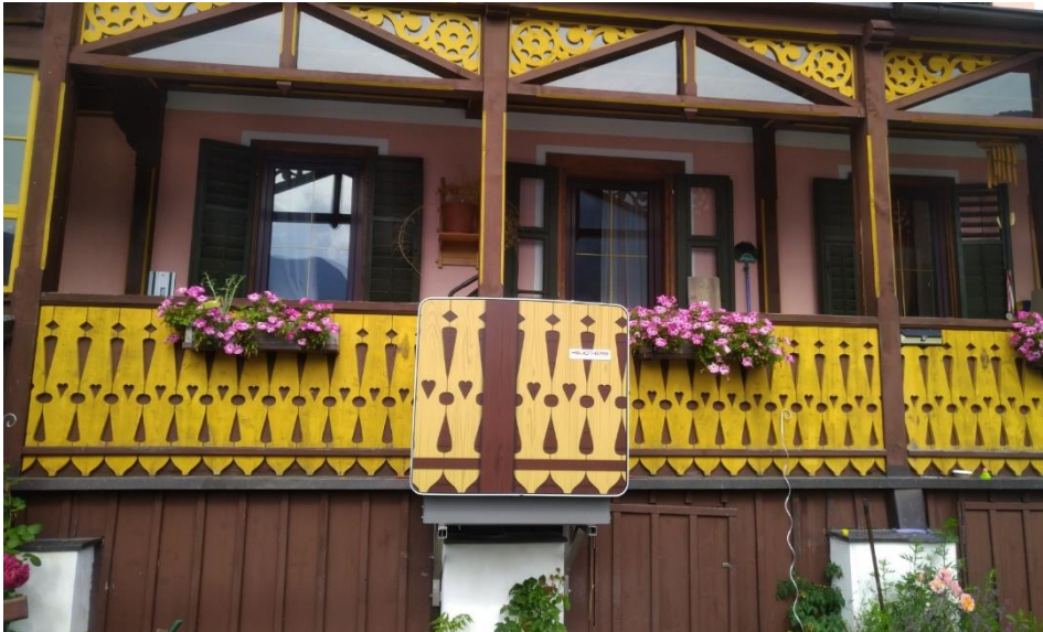
Abbildung 2: Wärmepumpe nach Sanierung
