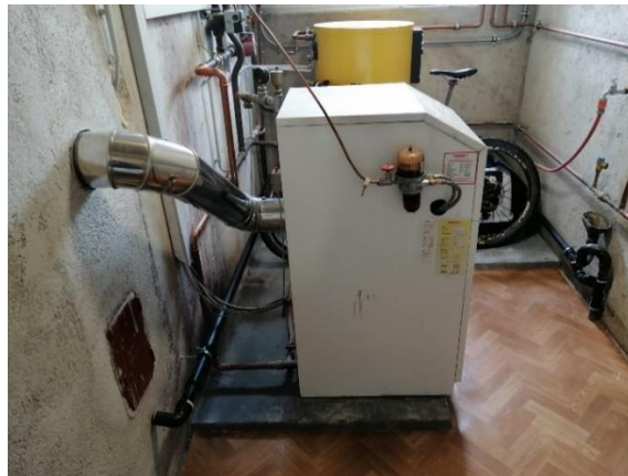
Abbildung 1: Heizkeller vor dem Austausch
