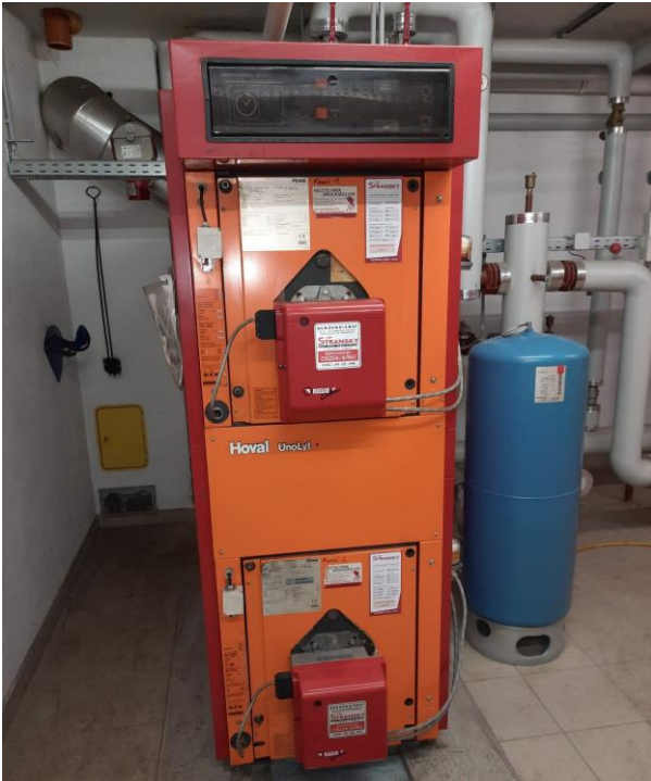
Abb. 1 Ölkessel der zentralen Wärmeversorgung
